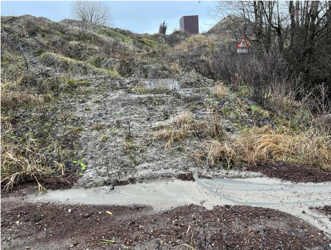
Figur 2 Afstrømning af overfladevand fra nyanlagte jordvolde syd for virksomheden. På fotoet ses udvasket ler.
