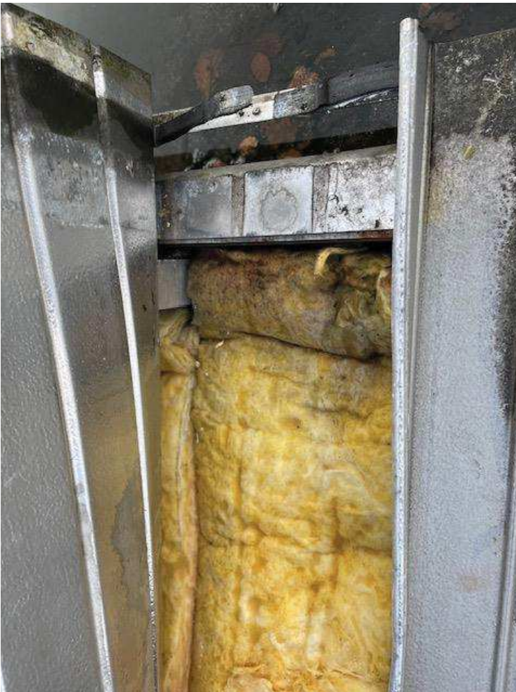
Foto nr. 4. Der blev registreret at oversiden af isoleringen var opfugtet pga. kondens fra kal-zip tagplader.
