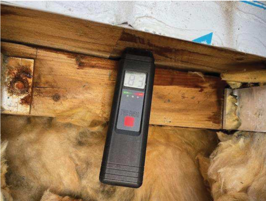
Foto nr. 11. Meget fugtigt træværk. Fugtindhold i træbjælke blev målt til 83 %, synlig opfugtning af trælægte, og kraftig korrosion af sekskantskruen ifm. vinkelbeslag.
