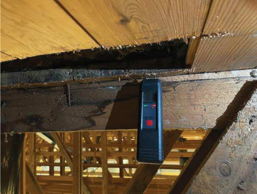
Foto nr. 23. Fugtindhold i bræddelag i oprindelig tagkonstruktion blev målt til 43 %
