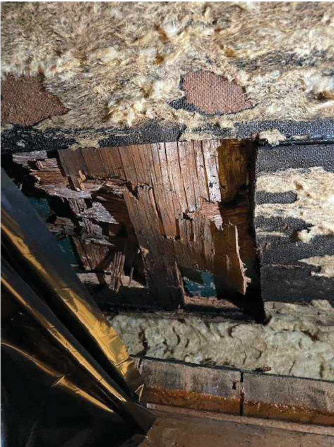
Foto nr. 24. Oprindelig krydsfinér-plade i den nordlige skotrende er nedbrudt, og uden bæreevne.
