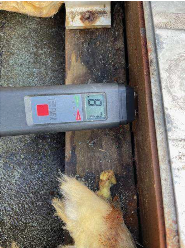
Foto nr. 5. Fugtprocenten i langsgående bjælke (50x125 mm) blev målt til 87 %. Bemærk korrosion af M6 sekskant skruen til fastgørelse af vinkelbeslag i trælægten.
