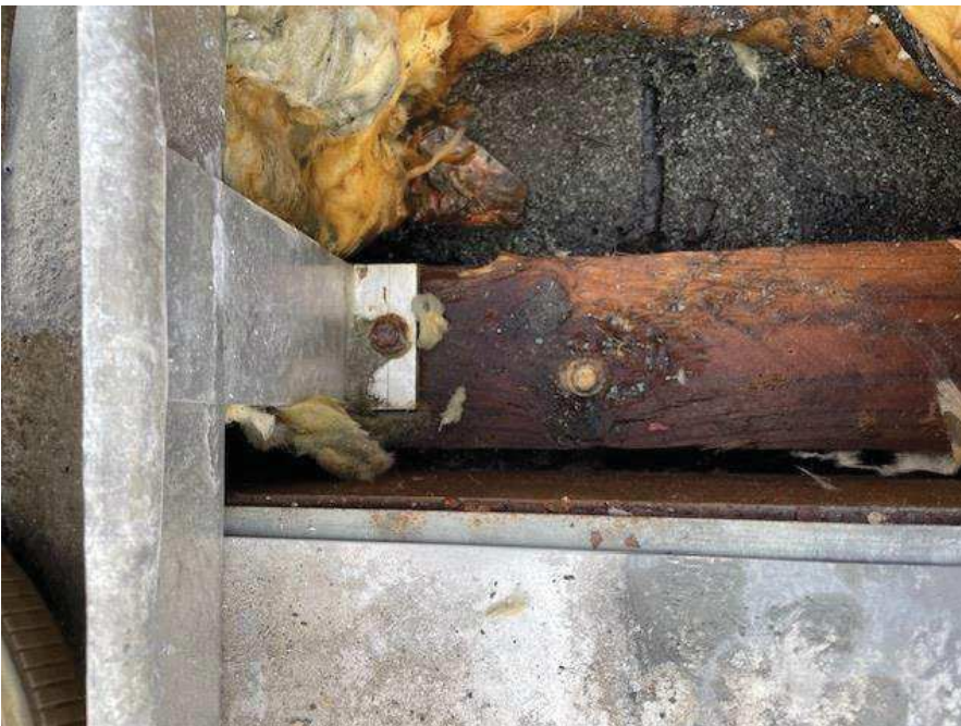
Foto nr. 2, kraftig korrosion af M6 sekskant skrue ifm. fastgørelse af vinkelbeslag ned i trælægte.
