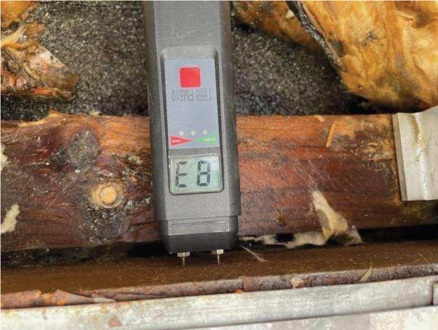
Foto nr. 1. trækonstruktion ved skotrenden er meget opfugtet. Fugtprocent blev målt til 83 % i langsgående træbjælke (50x125 mm) og 82 % i langsgående trælægte (50x75 mm) til fastgørelse af vinkelbeslag. Bemærk også korrosion af M6 sekskantskruer til forankring af trælægte ned i oprindelige tagpaptag.
