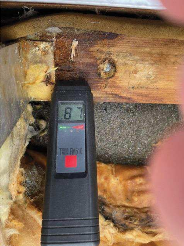
Foto nr. 17. Nederste del af tagisoleringen var meget opfugtet. Fugtindhold i trælægten blev målt til 87 %. Bemærk at skruehovede og stålskiven tilsyneladende er bortkorroderet ved skruefastgørelse i lægten.
