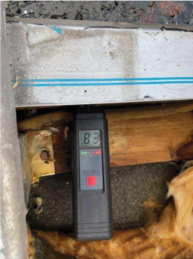
Foto nr. 19. Fugtindhold i træbjælken blev målt til 83%. Sekskantskruen ifm. vinkelbeslag er korroderet.
