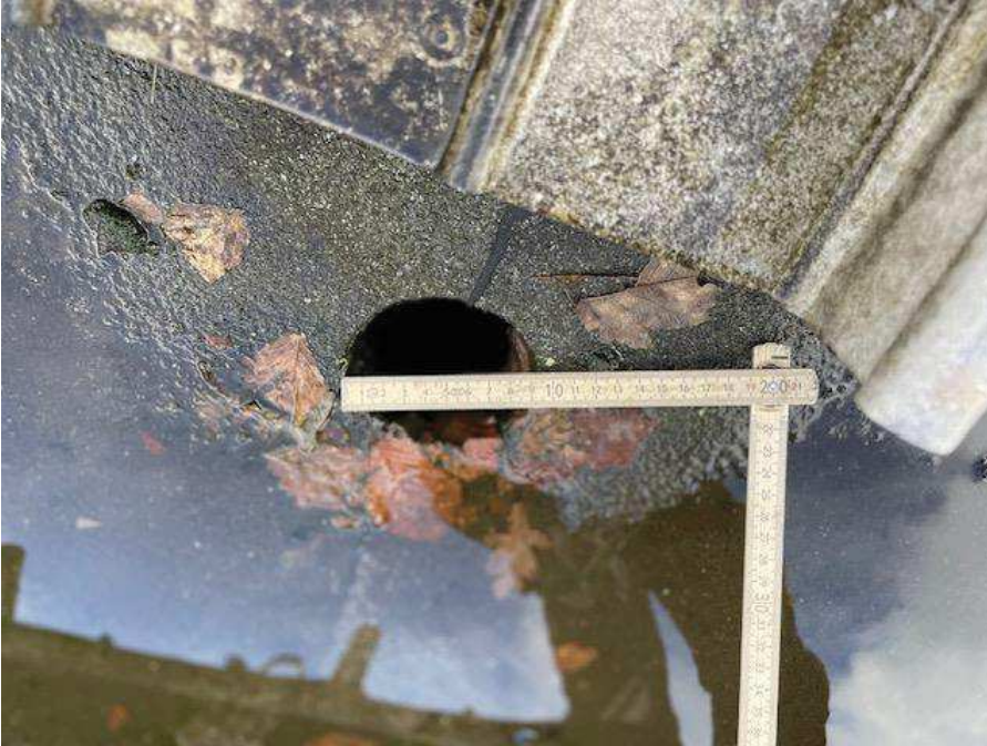
Foto nr. 3. Manglende bladfang ifm. 90 mm afløb i skotrende.
