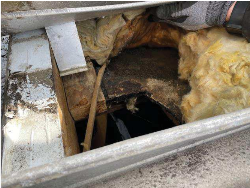
Foto nr. 14. Meget fugtig tagisolering. Der er tidligere foretaget åbning af tagkonstruktion igennem oprindelig tagpaptag. Bemærk at vinkelbeslag ikke er fastgjort til trælægten pga. løstsiddende korroderet sekskant-skrue.
