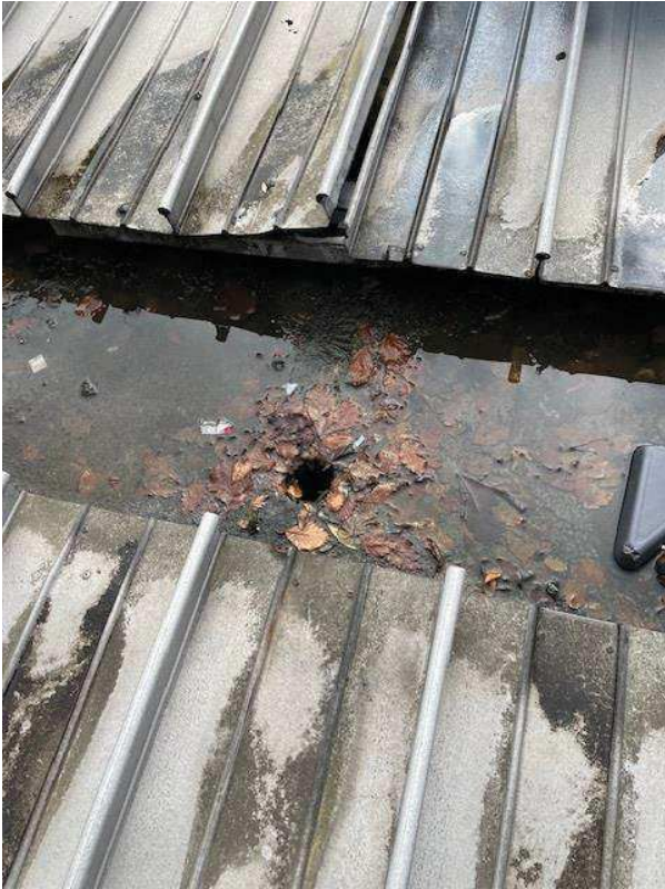
Foto nr. 13. Vandansamling og blade ved tagbrønd. Der mangler bladfang ifm. tagbrønd.
