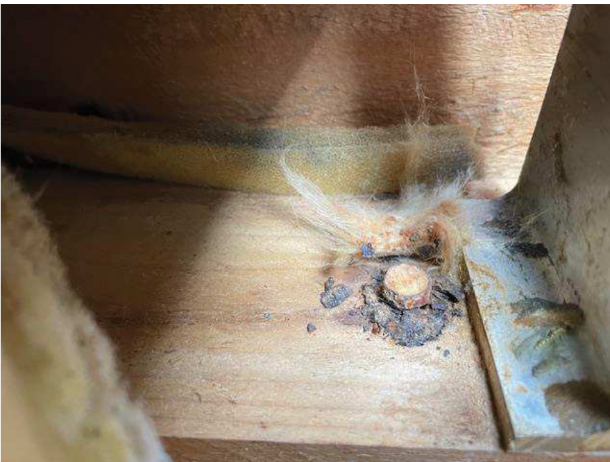
Foto nr. 12. Korrosion af sekskantskruen til fastgørelse af trælægten ned i tagkonstruktion. Skrueskiven er bortkorroderet.
