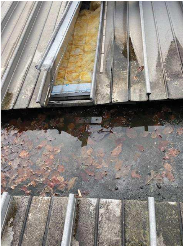
Foto nr. 10. Vandansamling og mange blade i skotrenden. På Kalzip-plader ses algebegroninger til hvor regnvandet opstøver ved kraftige regnskyl. Meget fugtig tagisolering.
