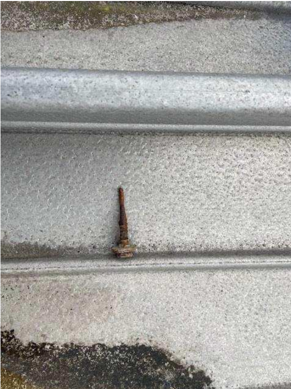
Foto nr. 15. Den korroderede sekskantskrue der var fastgørelse af vinkelbeslaget ned i trælægten (var løst-siddende).
