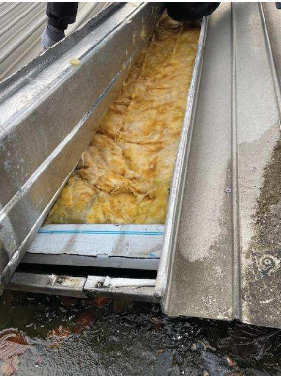
Foto nr. 16. Nederste del af tagisoleringen var meget opfugtet. Bemærk algebegroninger på KalZip-tagplader til hvor regnvandet opstøver ved kraftige regnskyl.
