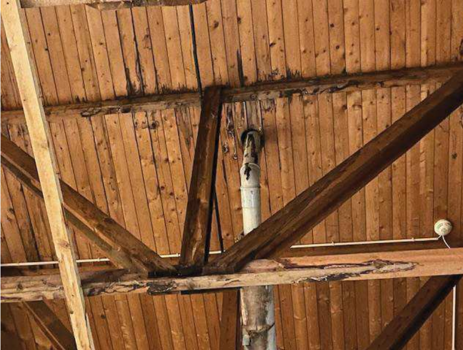
Foto nr. 25. Synlige fugtskjolder ifm. taggitterspær og træbrædde-lag ifm. tagnedløb i den sydlige skotrende.
