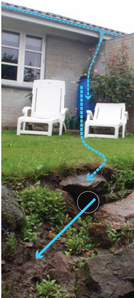
Figur 5: Tagvandet ledes via et rør til regnbedet (i forgrunden skjult under en sten). På nedløbsrøret er opsat en tønde til opsamling af regnvand til havevanding. Slagslunde, Egedal Kommune. Foto Orbicon.
