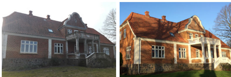
Udbynedervej 1, Udbyneder. Tilskud til renovering og maling af pudsede detaljer på facade.
