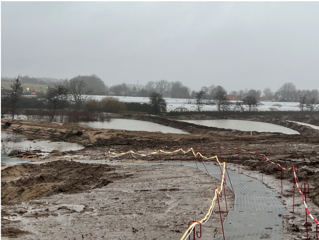
Figur 2 Øvrige bassiner til overfladevand mod nord står stadig fyldt - modsat side af gartneriet
